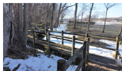
立ち入り禁止になっている木道
