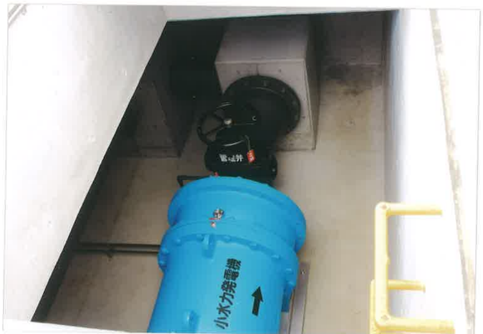
地下ピットに設置した発電機
