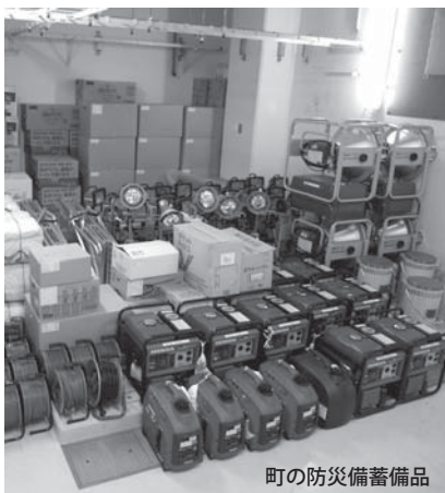
町の防災備蓄備品
