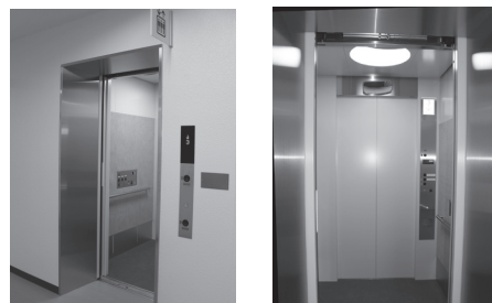
スルー型エレベーター
