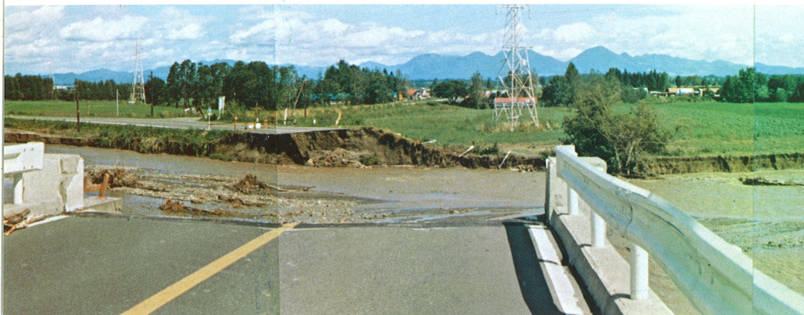
取付道路が決壊するなど大きな被害を受けた鹿追橋とその周辺
