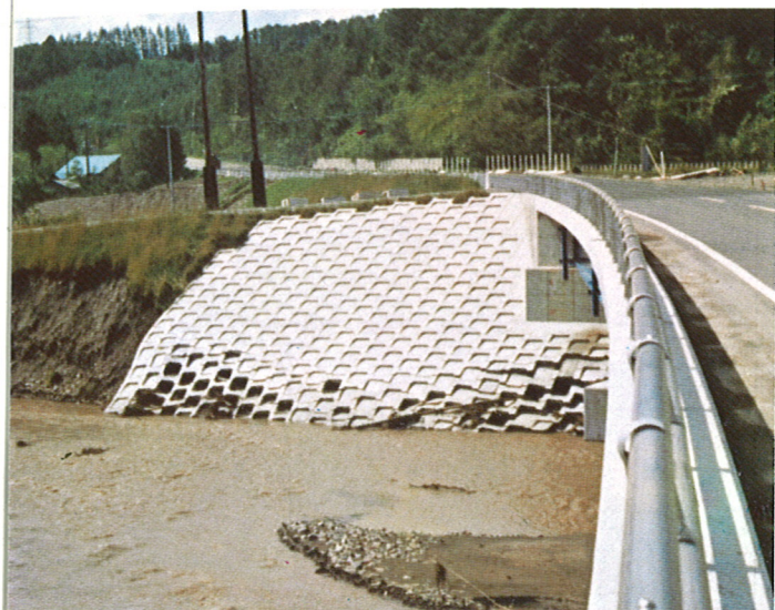
災害に見舞われた直後の万代橋付近右岸
