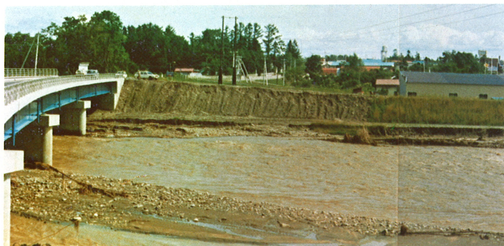
災害に見舞われた直後の 万代橋付近右岸
