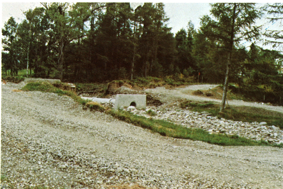
道路、農地流亡により露出してしまった 側溝横断管 (西瓜幕地区)
