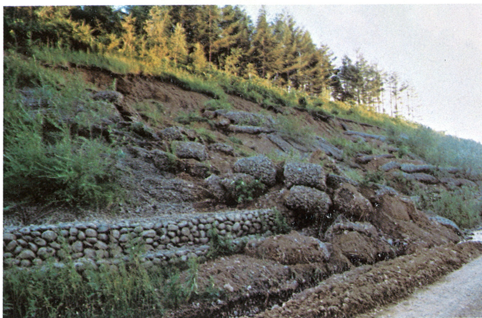
土砂崩れ防止用の「ふとんかご」もズタズタ (笹川上幌内線)
