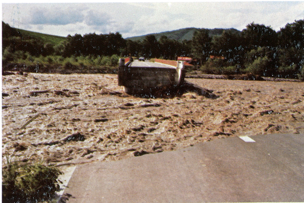
取付道路がすっかり濁流に持っていかれた 西瓜幕橋
