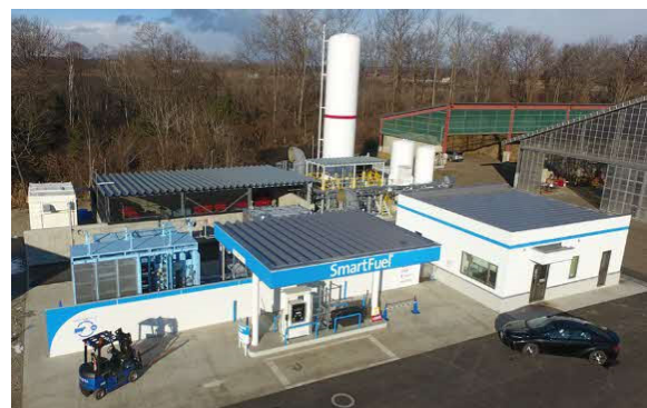
図11 水素製造施設、水素ステーション
