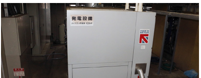
中鹿追バイオガスプラントの100kw発電機
