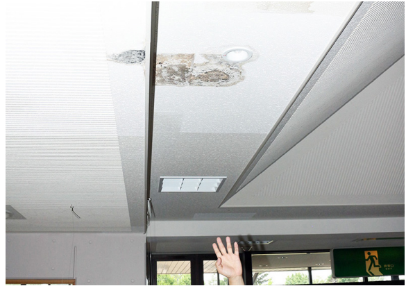
トリムセンター 複数箇所天井から雨漏り
