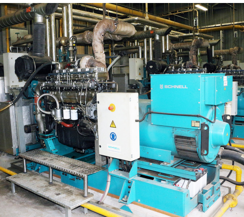
瓜幕バイオガスパラントの発電機
