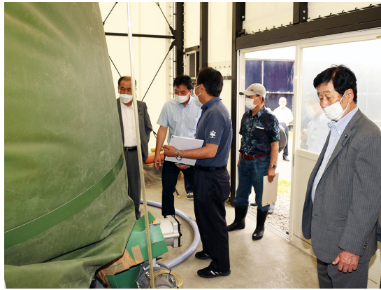
中鹿追バイオガスプラント ガスバッグでメタンガスを貯蔵
