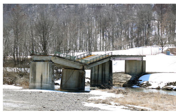
解体予定のクテクウシ橋 一部の橋脚及び主桁は解体済
