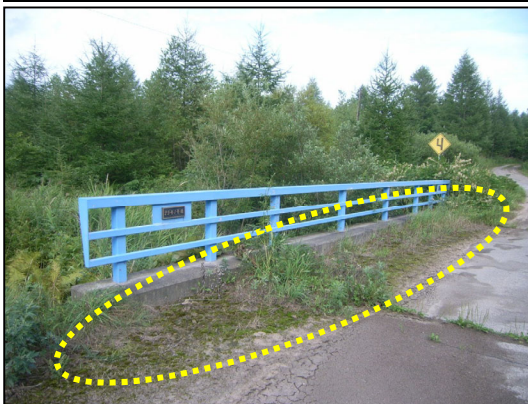
写真1：路面の土砂堆積の例
