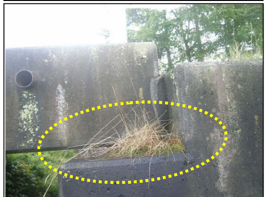
写真2：橋座の土砂堆積の例
